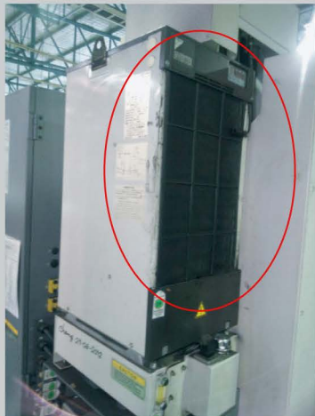
工作機械メーカーに多く採用 されているオイルチューナー のコンデンサ汚れ
